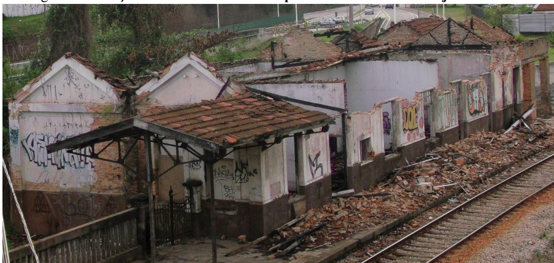
Figura 15. Estação Ferroviária da CPEF após incêndio ocorrido em julho de 2018.
