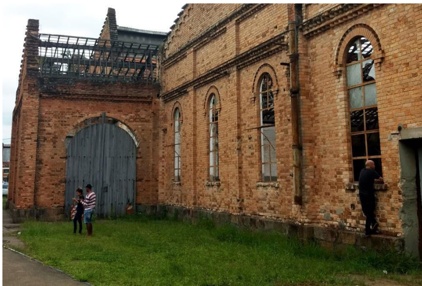
Figura 45. Atração pelas edificações em deterioração.
