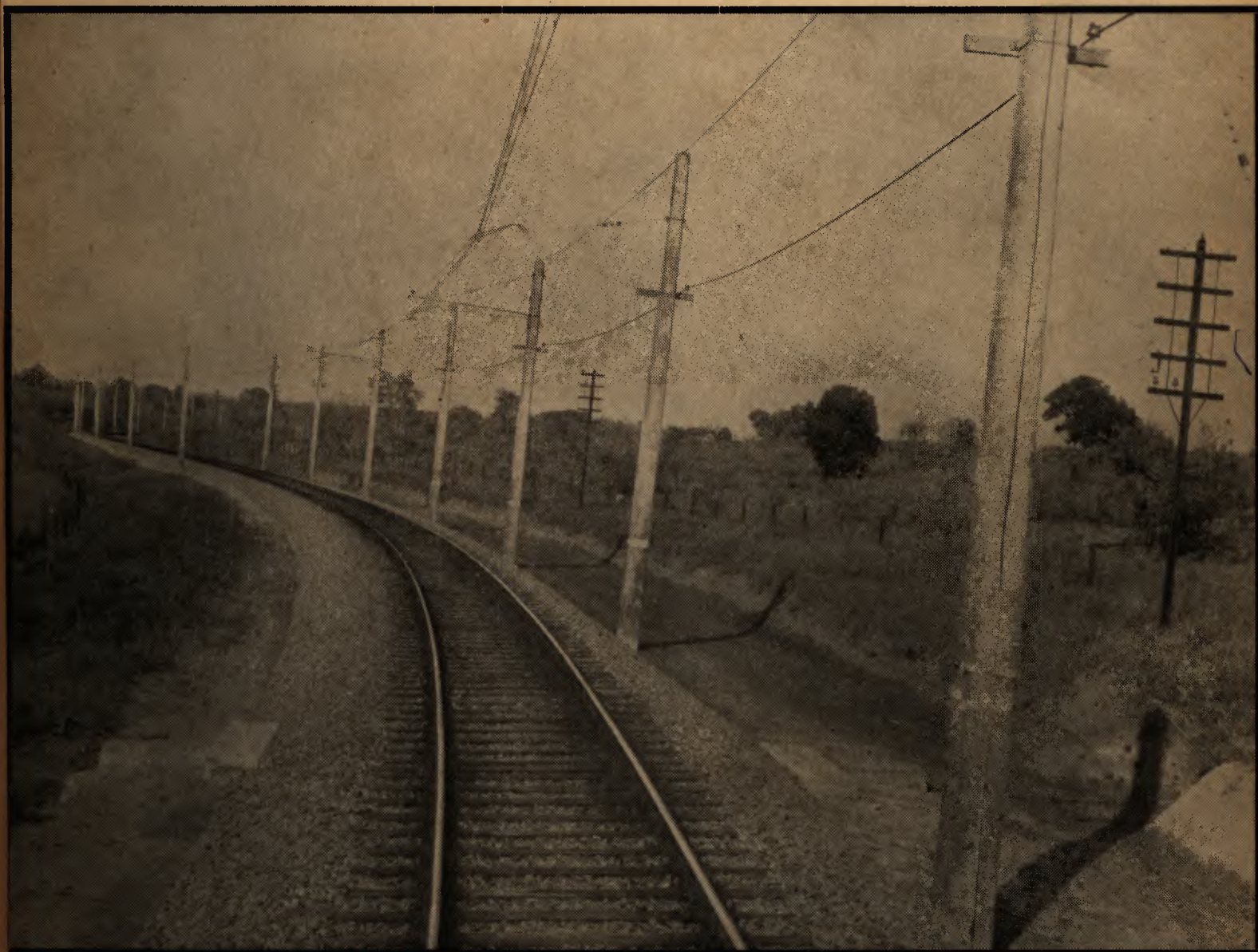
Trecho eletrificado da Linha Tronco
